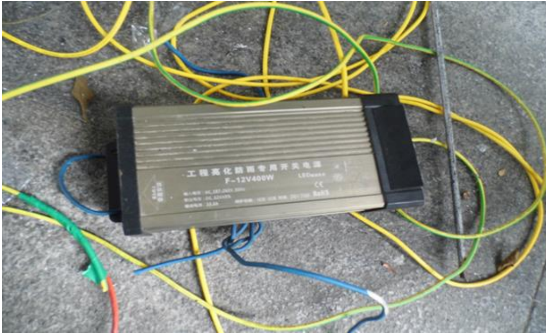
(图一) 咖啡馆大门口地下放着一个旧的电源转换器由此证明维修工在从事电器作业
